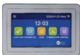
Sterownik przewodowy (zamontowany)
